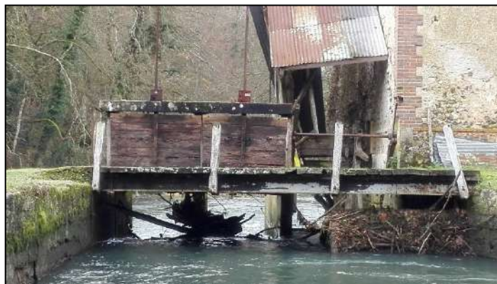
Figure 15 : Embâcles obstruant les vannages du moulin
